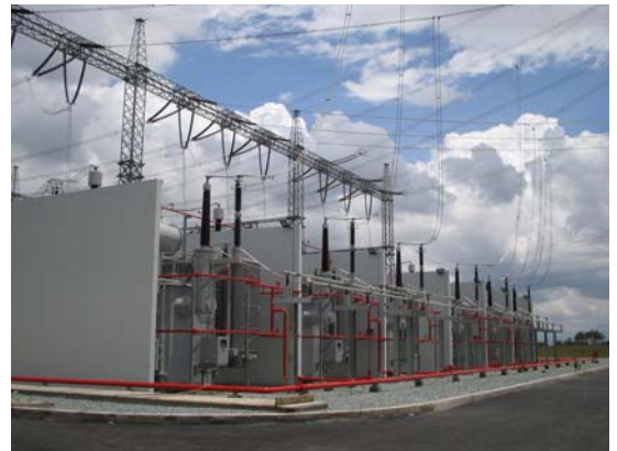
Trạm biến áp Nhà Bè
