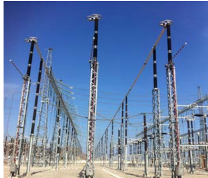
Sân phân phối 500kV Vĩnh Tân (Thanh cái cứng 500kV)
