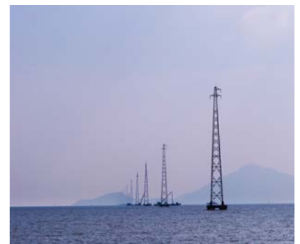
Đường dây 22kV vượt biển ra đảo Hòn Tre, huyện Kiên Hải
