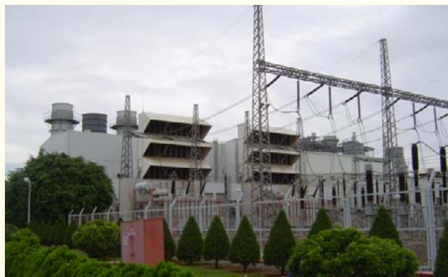
Sân phân phối NM Nhiệt điện Phú Mỹ 2.1 dự án EPC đấu nối NMNĐ Phú Mỹ 2.1 với hệ thống điện quốc gia
