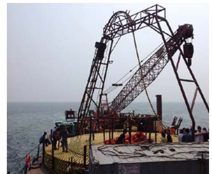
Xà lan kéo cáp ngầm 110kV xuyên biển Hà Tiên - Phú Quốc
