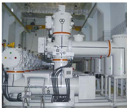
Trạm GIS 220kV Tao Đàn, TBA 220kV đầu tiên tại Việt Nam sử dụng công nghệ GIS, thiết bị hợp bộ cách điện 220kV bằng khí FS6
