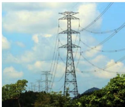
Đường dây 500kV Vĩnh Tân - Sông Mây
