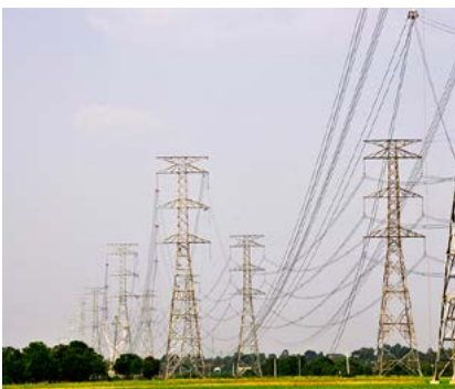
Đường dây 500kV Pleiku - Mỹ Phước - Cầu Bông
