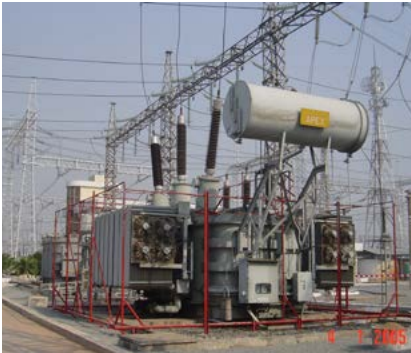
Trạm 500kV Phú Lâm, niềm tự hào đóng góp xây dựng thành công hệ thống điện 500kV đầu tiên
