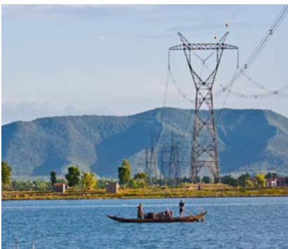
ĐD 500kV Bắc - Nam vượt sông Gianh
