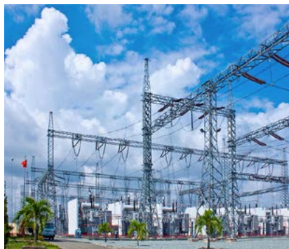
Trạm biến áp 500kV Nhà Bè
